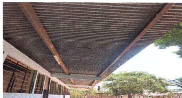
Foto 2: se observa el deterioro de constanera de la estructura portante de tres aulas.
