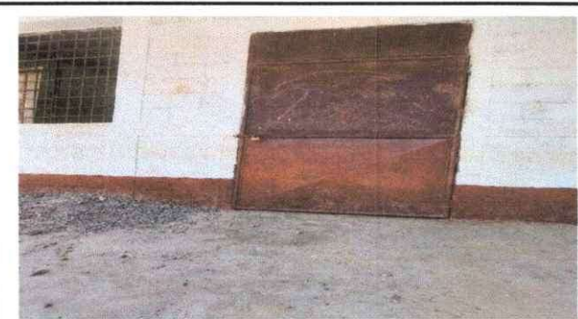
Foto 3: Se observa el deterioro de puertas de la estructura portante de tres aulas.
