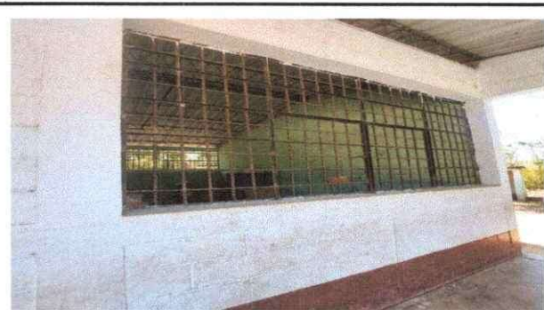
Foto 4: Se observa el deterioro de ventanas de la estructura portante de tres aulas.
